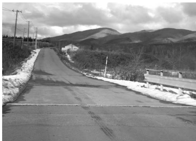
段差やひずみなど道路の老朽化も目立つ
