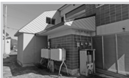
アカシア団地の灯油タンク
